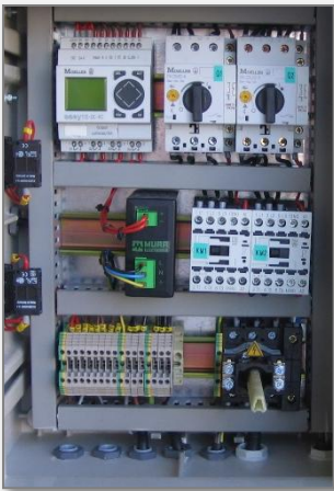
Cuadro eléctrico con programador
